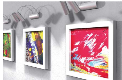
Installazione di plafoniere in serie
